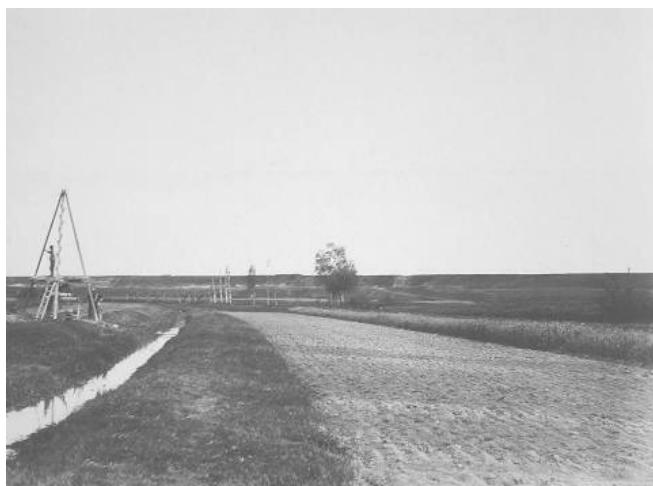
Photographie tirée de l'ouvrage de Denis Varaschin, la construction du canal de Jonage
